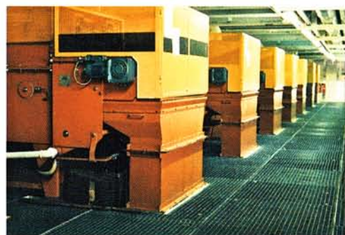
Druckbandfilteranlage zum Reinigen des Öles aus der Aluminiumbearbeitung der Zylinderköpfe.
